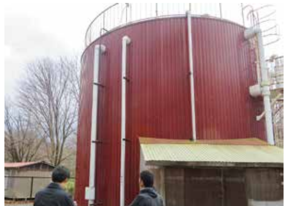
葛巻町 バイオマス発酵槽
