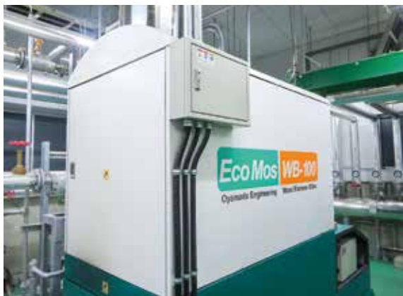
岩手県宮内温水プール チップボイラー
