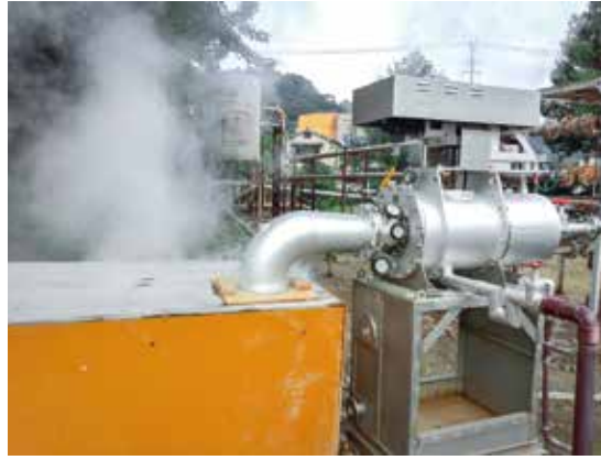
花きグループ湯けむり発電第3号実証機
