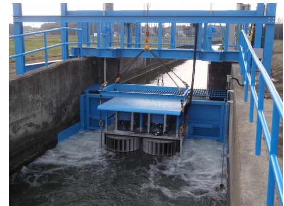
小水力発電設置例(内川小水力発電所)
