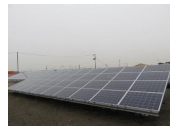
太陽光発電設備
