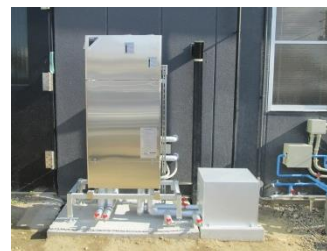
地中熱利用設備
