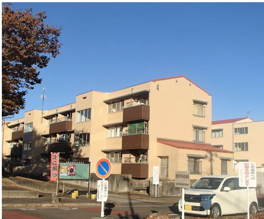
[建築から40年近くが経過した県営住宅の外壁を改修(断熱化)]
