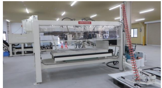
図 40：使用済太陽光パネルの処理設備
