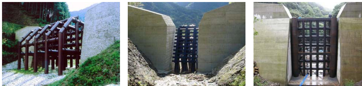
写真3. 土石流区域における部材間隔を狭めるタイプの施工事例
