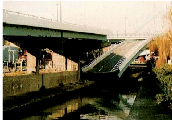
写真. 曲線橋の落橋(兵庫県南部地震)
