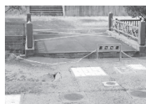
浄化槽付近の沈下
