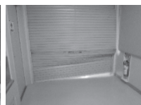
シャッターの破損
