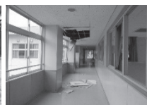
図書室前廊下天井の破損
