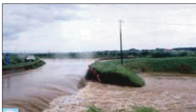
台風の大雨による ( ) で堤防が決壊
