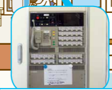
ひじょうほうそうせつび 非常放送設備
