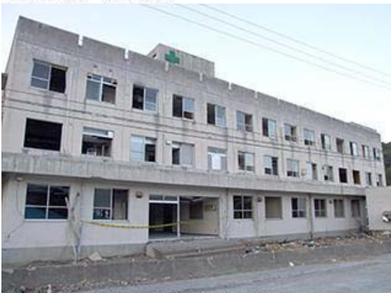
津波で大きな被害を受けた石巻市立雄勝病院
