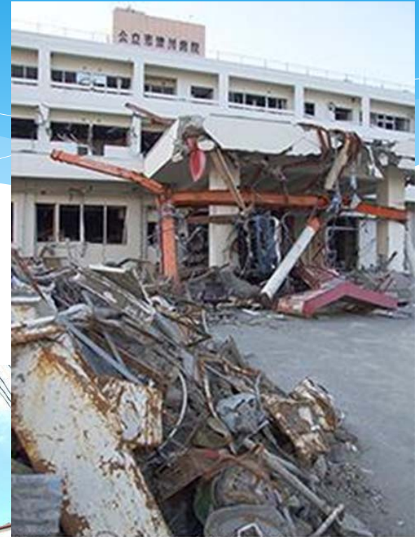
津波で大破した公立志津川病院
