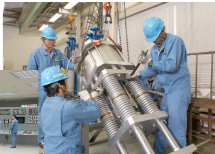
主蒸気隔離弁分解点検訓練
