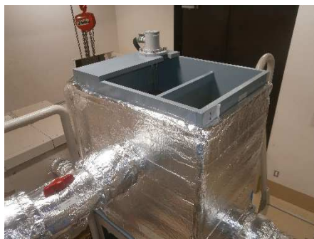
放水口モニタ混合槽(2号機)
