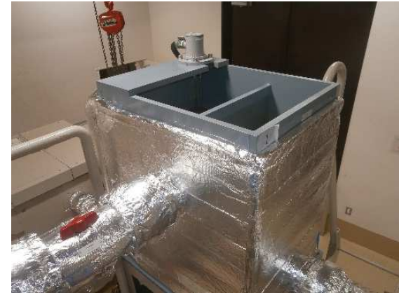
放水口モニタ混合槽(2号機)
