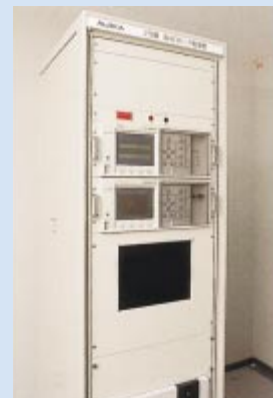
放水口モニター監視盤(2号機)
