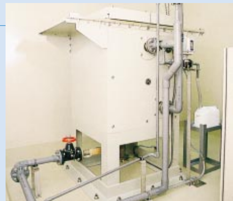
放水口モニター(2号機)
