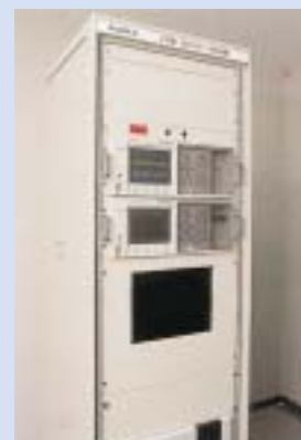
放水口モニター監視盤(2号機)
