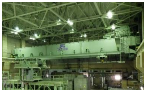
原子炉建屋天井クレーン 全景
