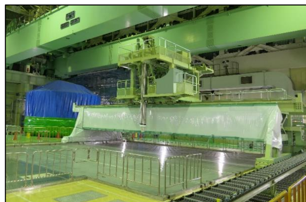
燃料交換機外観
