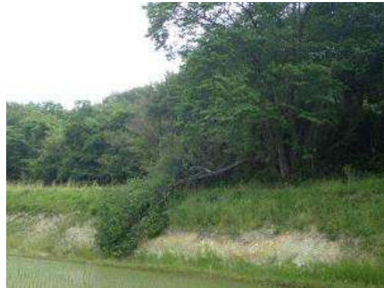
▲老朽化事例（堤体途中に倒木）
