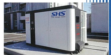
スマート水素ステーション
