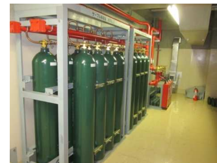
固定式消火設備
