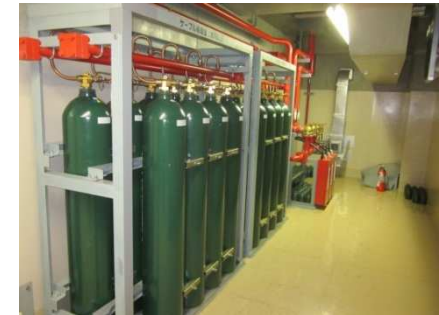
固定式消火設備
