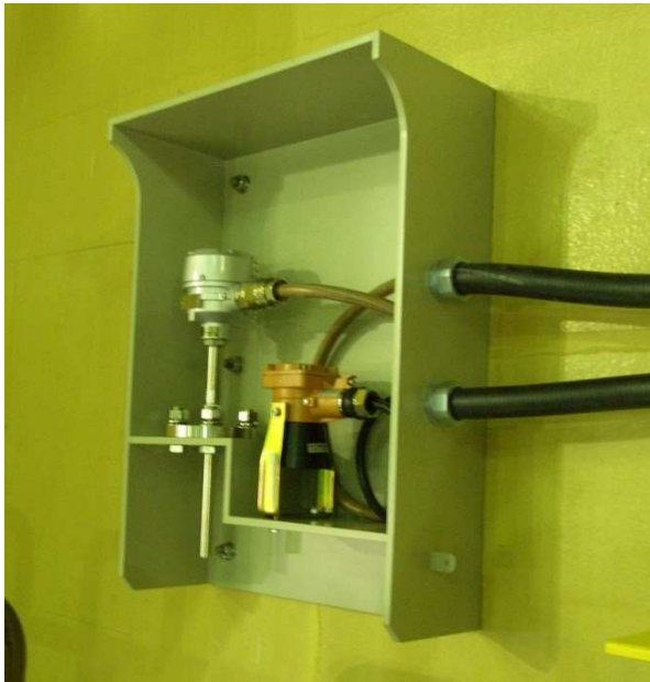
水素検知器（2台）
