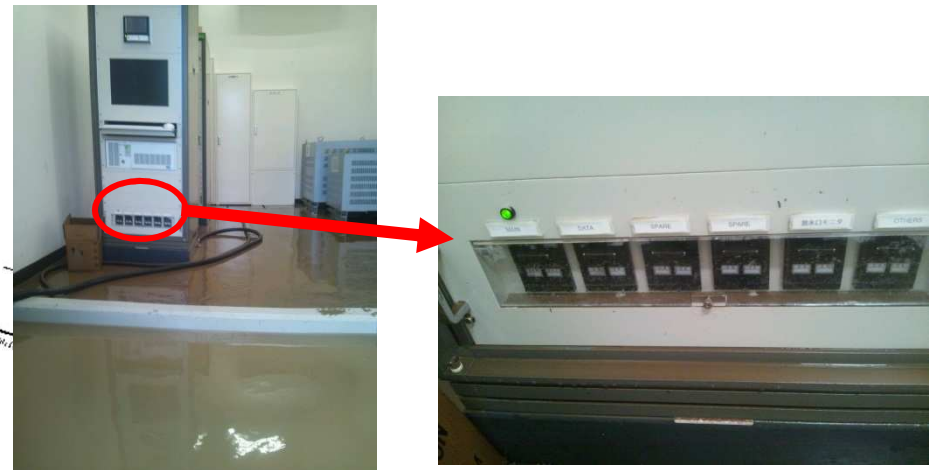
現場監視盤(3号機放水口モニタ局舎内)
