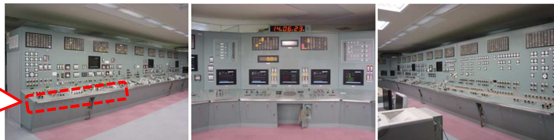
中央制御室制御盤の配置
