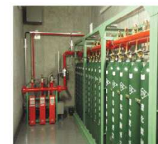
自動消火設備
