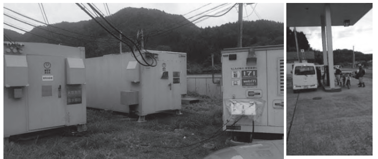
停電エリアでの移動電源車による通信ビルへの電源供給と 近隣スタンドへの支援
