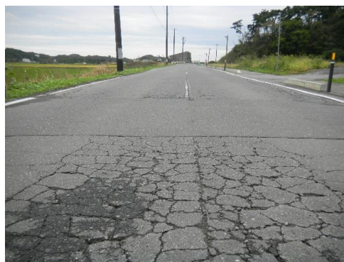
■ 町道手樽・富山駅線の舗装破損状況
