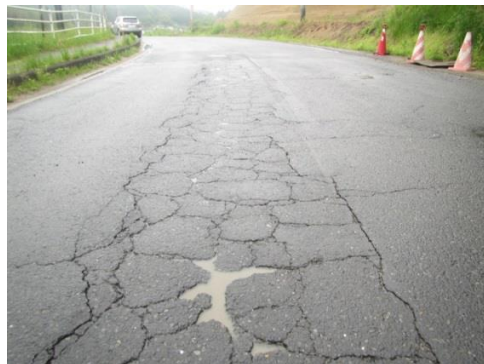
■ 農道上下堤・竹谷線の舗装破損状況
