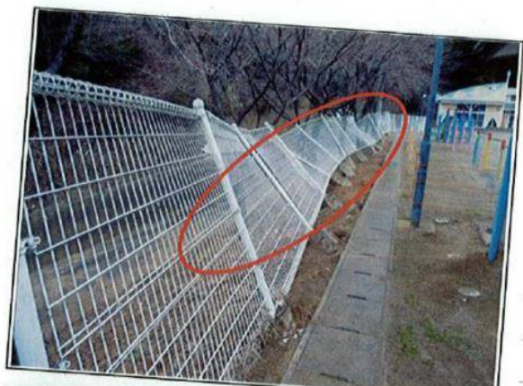
①津波により園庭フェンスが破損
