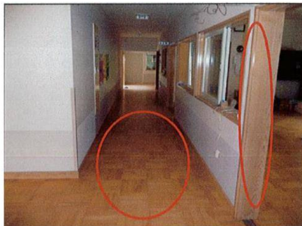
②施設内は床上浸水
