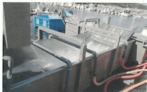
平成23年度事業で整備したボイル釜
