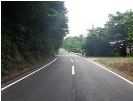
【(一)牡鹿半島公園線 石巻市十八成浜(6)地内】
