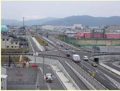
①門脇流留線道路改築工事 ②石巻市門脇～魚町地内 ③高盛土道路及び側道部 施工中 ④61%
