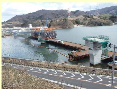
①浦宿道路改良工事 ②女川町浦宿浜地内 ③浦宿地区で橋梁上部工事を施工中 ④72%
