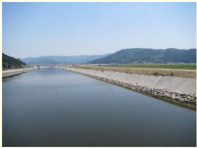
①真野川外4河川災害復旧工事 ②石巻 市大瓜地内外 ③真野川上流及び石崎橋 旧橋撤去準備中 ④92%
