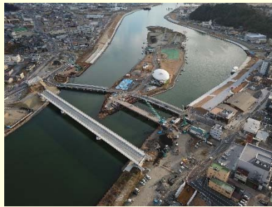
①国道398号内海橋災害復旧工事 ②石巻市中央地内 ③内海橋が完成 取 り付け道路を施工中 ④73%
