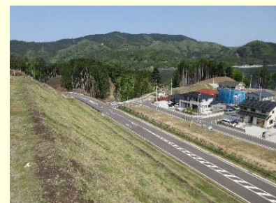
①飯子浜復興道路工事 ②女川町飯子浜地内 ③道路改良及び上部工工事を施工中 ④67%
