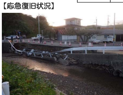
【応急復旧状況】 内の原川の護岸欠壊（石巻市真野）
