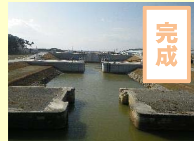
①北北上運河災害復旧工事 ②石巻市蛇 田地内外 ③H31.1完成 ④100%
