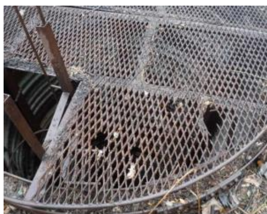
図 3.3 集水井工の蓋の損傷・劣化
