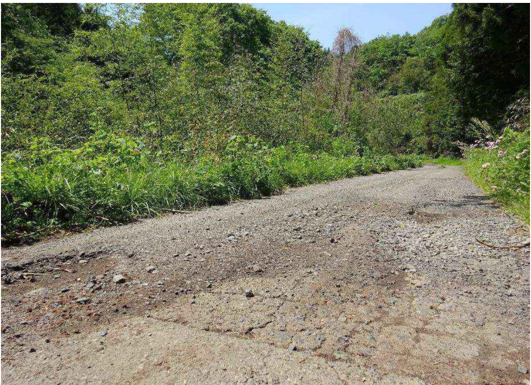
老朽化した舗装状況
