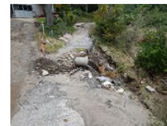
写真：道路法崩れ状況
