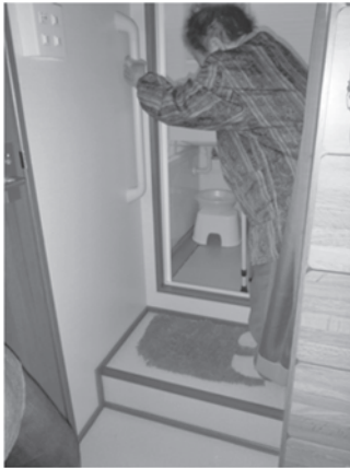
写真4-2 応急仮設住宅の浴室入り口の敷居段差と浴槽縁の高さで動作が困難
