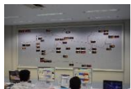
流量・水圧等の監視 (24時間・365日)
