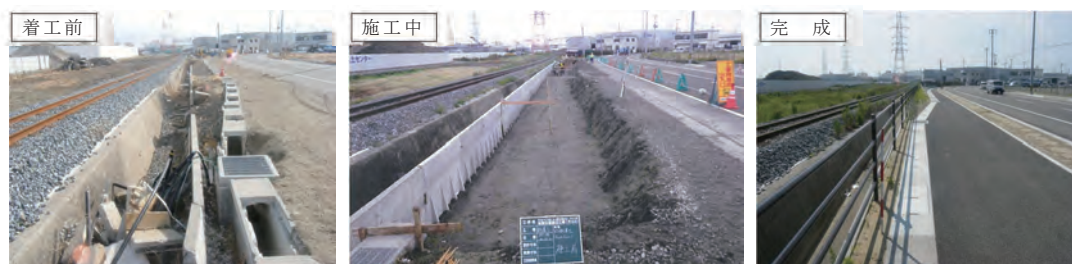
港北工業幹線 街路災害復旧状況
