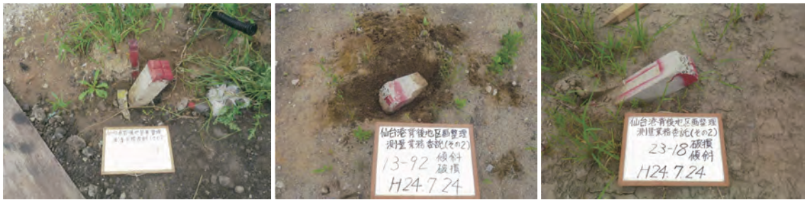
震災により破損した境界杭
