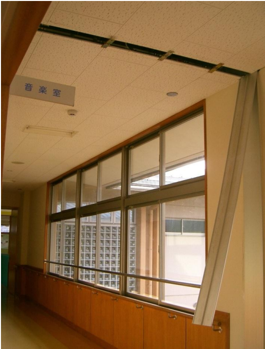
エキスパンションジョイント落下の状況
