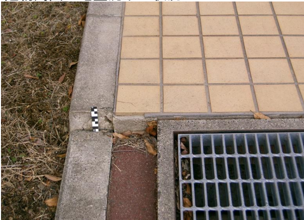
建物周囲の地盤沈下の状況
