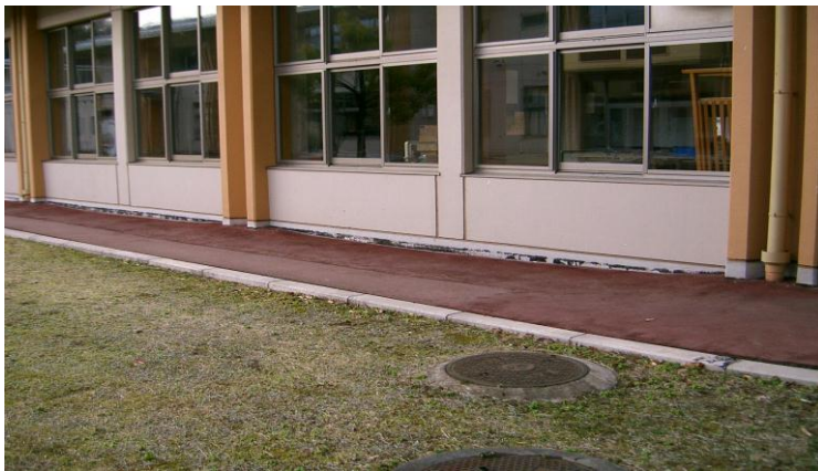
中庭の地盤沈下の状況
