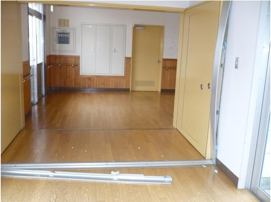
東日本大震災被害の記録：写真（石巻支援学校）
