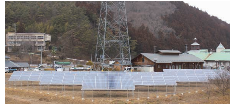
道の駅「林林館」脇に建設された「東和町ほたるの里発電所」
