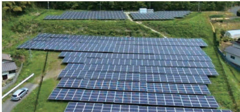
上多田川小学校跡地の太陽光発電所
