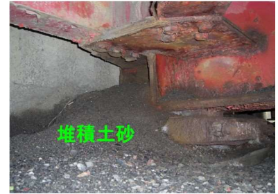
土砂堆積状況
