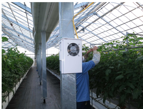
②通路に設置
