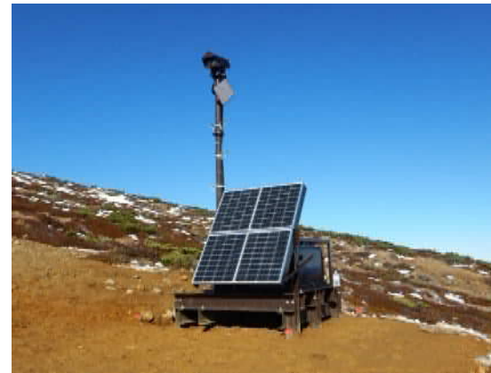
2015年11月4日(カメラ設置時) 電源: バッテリ・太陽電池パネル
