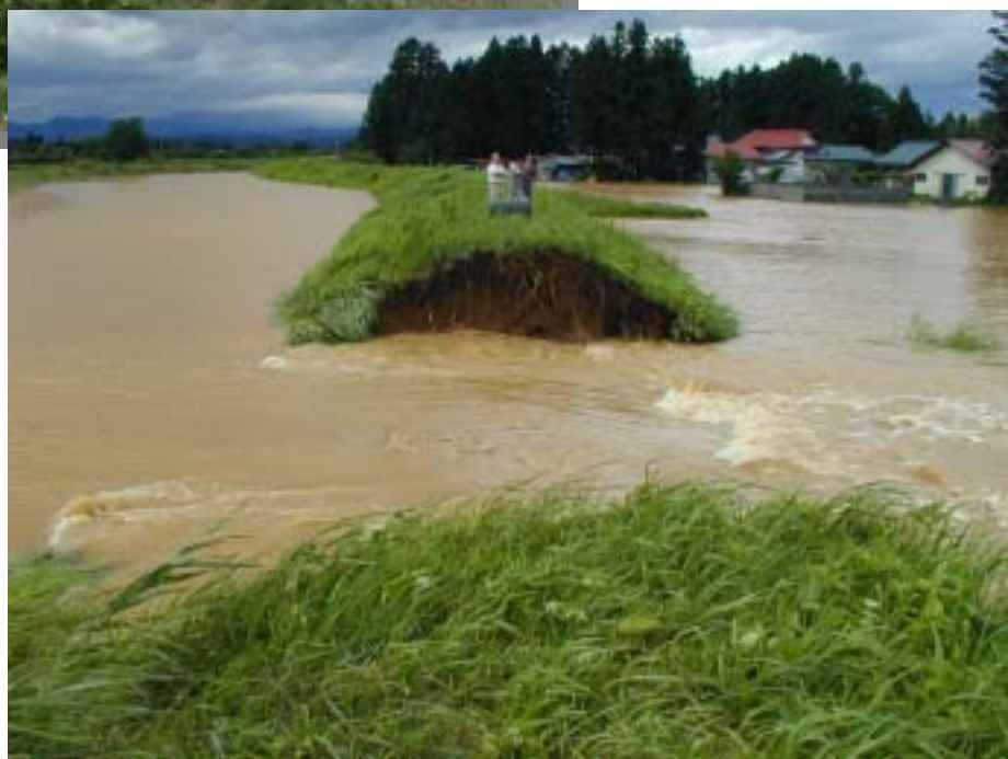
二迫川 破堤状況（栗駒町）
