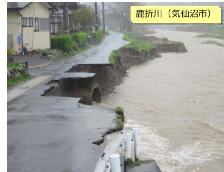
平成24年5月低気圧による大雨で河岸浸食が生じた鹿折川
