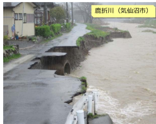
平成24年5月 低気圧による大雨 による被害状況
