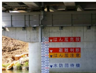
橋脚への水位表示例
