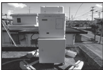
県南地区設置 可搬型モニタリングポスト
