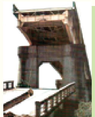
昭和53年の宮城県沖地震による落橋
